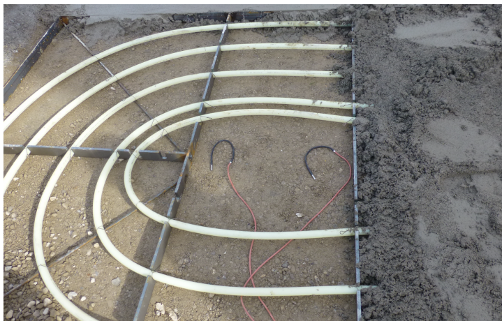
Bild 4: Die Fühler zur Einschaltung der Kollektorpumpe liegen mit grösserem Abstand zu den Rohren. Sie sollen nach einem kurzen Einschalten nicht reagieren, wenn der Vorlauf zur Zentrale im Moment noch kühler ist als der Sondenrücklauf.
