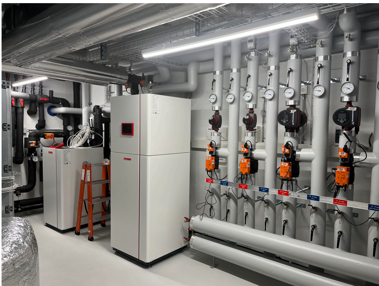
Bild 5: Heizzentrale mit den beiden Ochsner Wärmepumpen mit 14 und 40 kW Heizleistung. Im Hintergrund die Anschlüsse der 6 Erdsonden.
